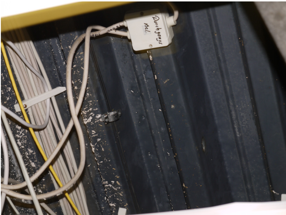
Fleckige Abplatzungen der Beschichtung
