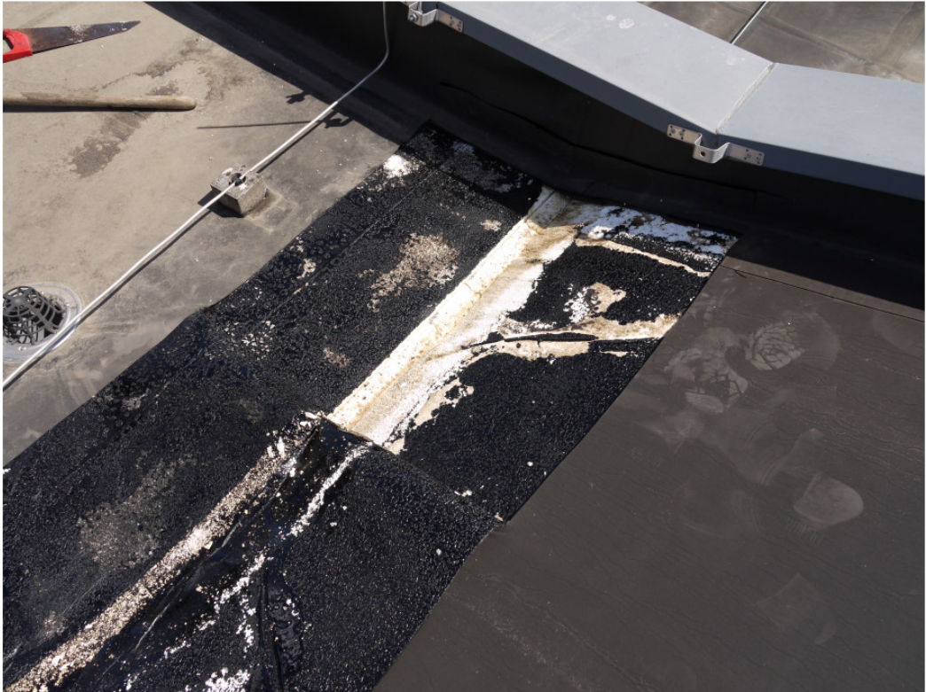
Prüfstelle 2 mit Feuchteabzeichnungen
