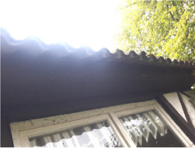
Abb. 11: Gartenhäuschen, Eterniteindeckung, Quartiermöglichkeit für Fledermäuse
