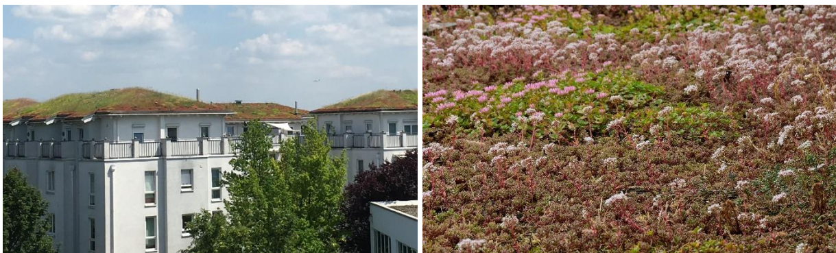
Abbildung 8: Beispiel einer Dachbegrünung (Wohngebiet Wiesbaden Erbenheim und Garagenbegrünung Nackenheim) (Bildquelle: © J. Tauchert 2015/2016)
