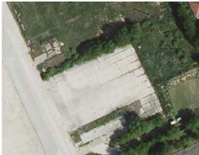
Entwässerungsgraben und Leichtflüssigkeitsabscheider
