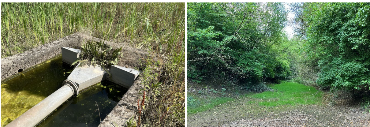
Abbildung 15: Zustand bestehender Retentionsbecken (links) und RRB 2 A+B (rechts) (Quelle: Eigenes Foto)
